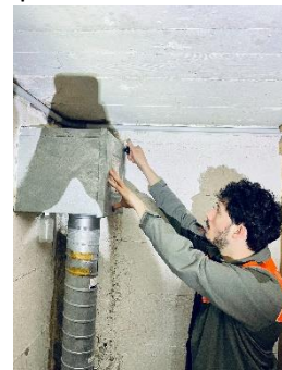
Entretien des ventilateurs dans une construction de protection civile.
